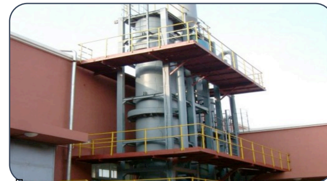
Пилотная установка, предназначенная для одновременного сжигания угля и биомассы, а также для очистки газа, построенная иностранным партнером
